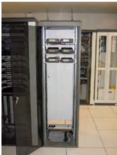
Bastidor con equipos para la interconexión con otras redes TETRA
