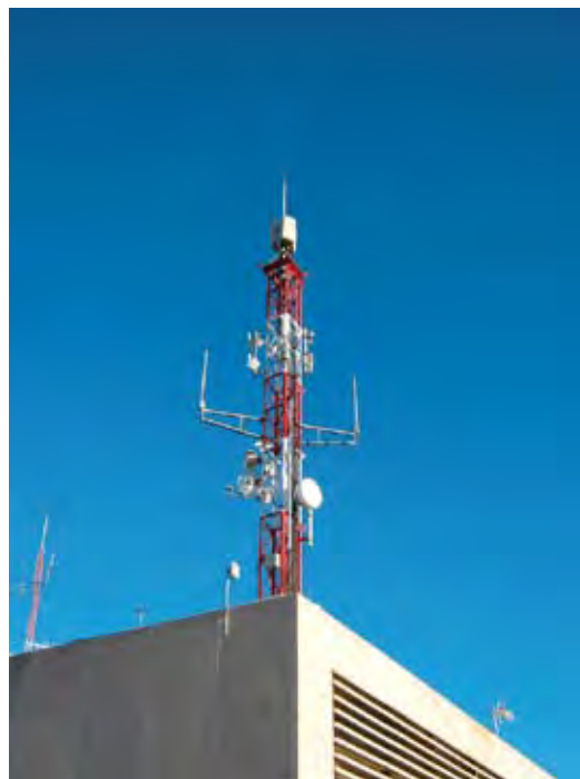
Torre de estación base con antenas TETRA y de la red de transmisión por radio
