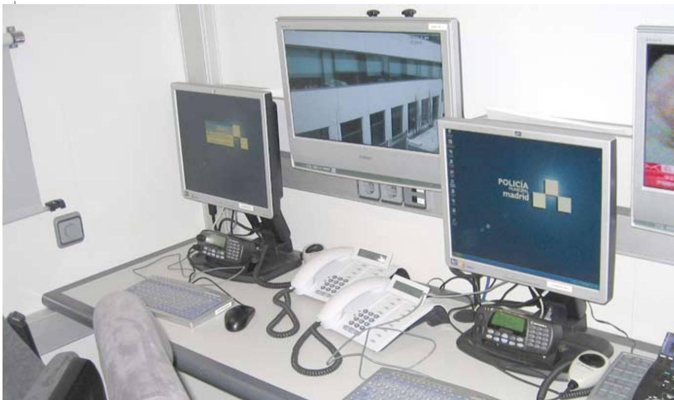
Detalle de los equipos de comunicaciones disponible en el interior del Centro de Mando Móvil
