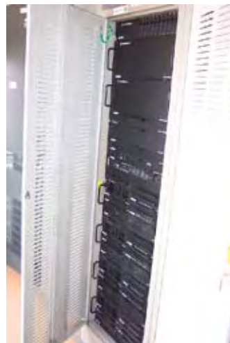
Bastidor con estación base del sistema DIMETRA
